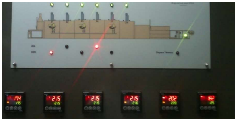
Figura 28. Panel de control de horno industrial
