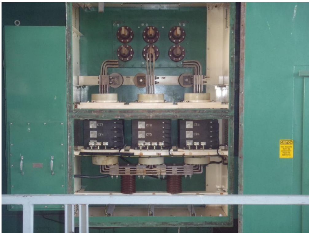
Figura 16. Cubículo del neutro del generador
