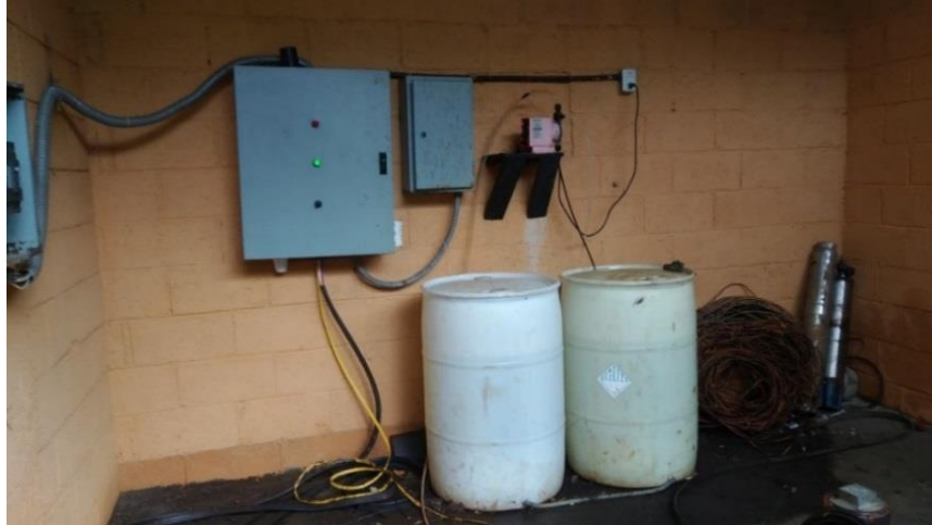
Figura 23. Fotografía de la caseta de control del pozo Nueva Esperanza
