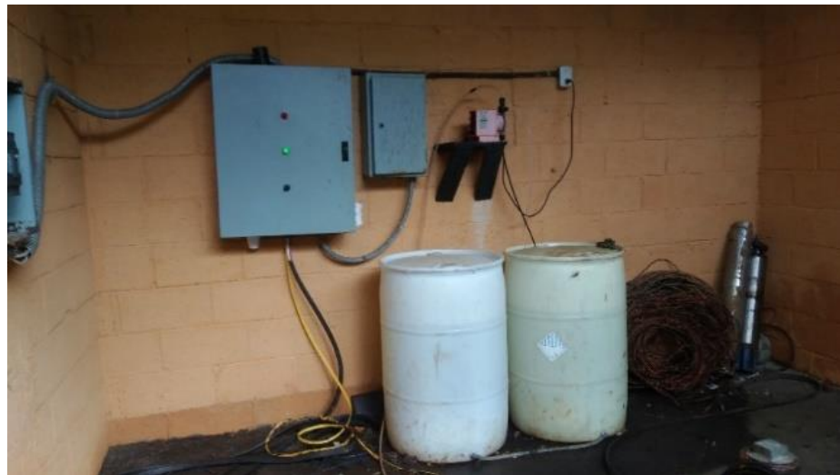
Figura 24. Fotografía del sistema de aplicación de cloro gas
