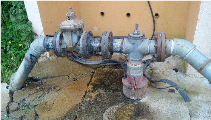
Figura 52A. Pozo zona 1 y 2
