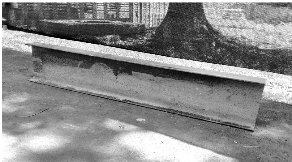
Figura 15. Viga “d” muestra sin pasos
