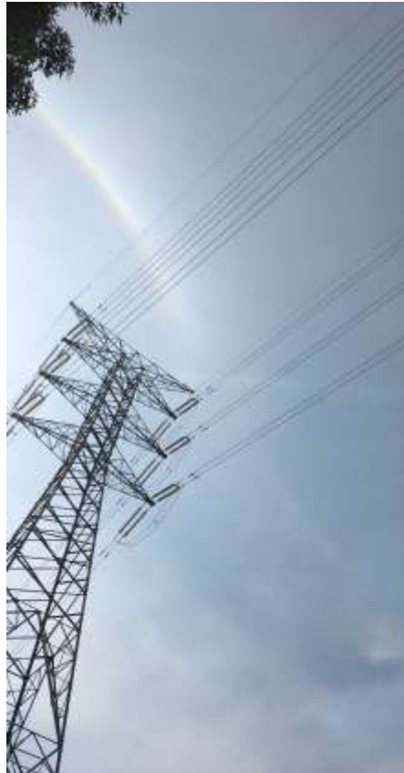
Figura 49. Fotografía de conductores de fase
