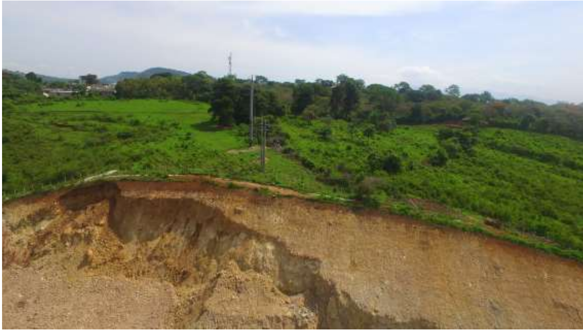
Figura 65. Vista panorámica de talud en riesgo
