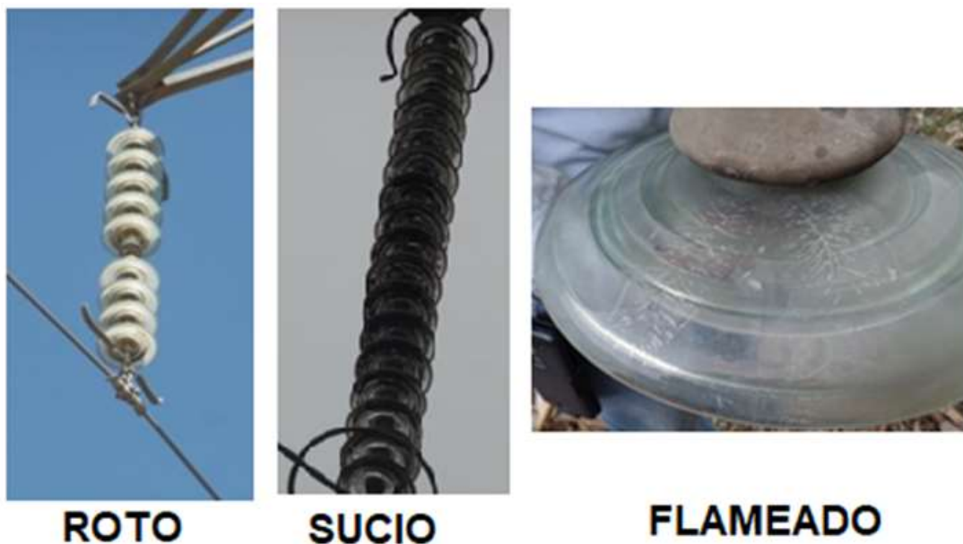
Figura 33. Discontinuidades por detectar en aislamiento de vidrio
