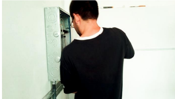
Figura 82. Conexión eléctrica hacia el tablero de flipones en el Laboratorio India 3
