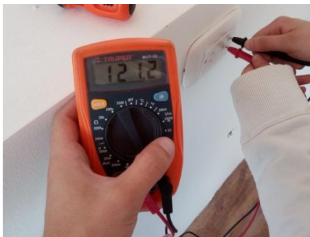
Figura 87. Tomacorrientes del Laboratorio India 3
