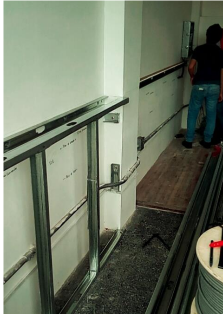
Figura 65. Marcado de las tuberías para los puntos de red y los tomacorrientes en el Laboratorio India 3
