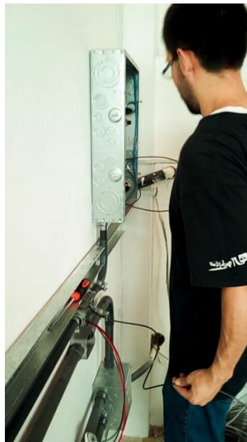
Figura 83. Conexión eléctrica hacia el tablero de flipones en el Laboratorio India 3
