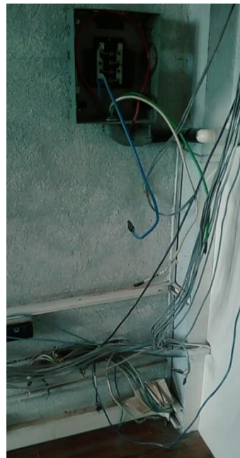
Figura 58. Tablero de flipones previo a la nueva instalación eléctrica del Laboratorio India 3
