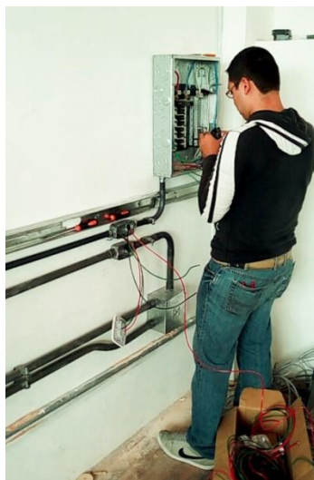
Figura 85. Conexión eléctrica hacia el tablero de flipones en el Laboratorio India 3
