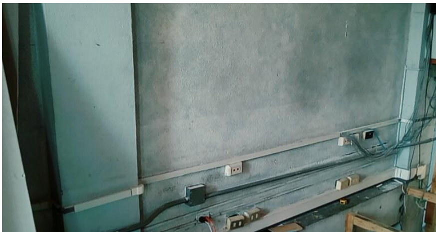
Figura 55. Conexiones antiguas del Laboratorio India 3
