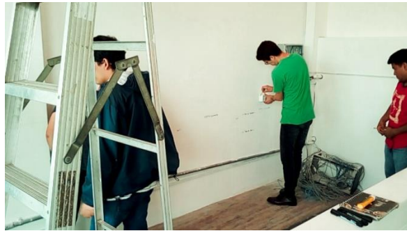
Figura 61. Medición de las distancias entre puntos de red y tomacorrientes en el Laboratorio India 3
