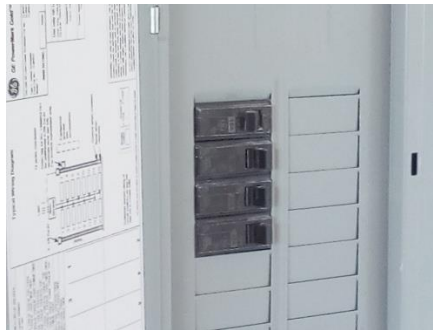
Figura 86. Tablero de flipones del Laboratorio India 3
