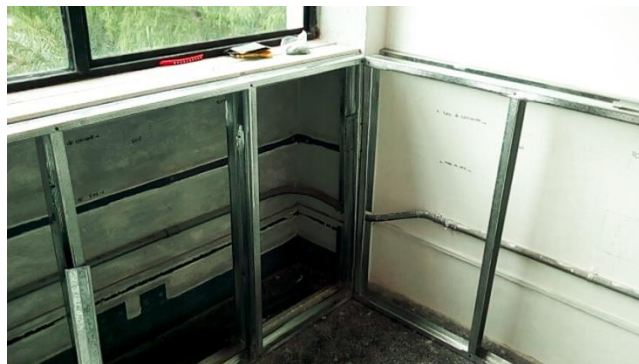
Figura 64. Marcado de las tuberías para los puntos de red y los tomacorrientes en el Laboratorio India 3
