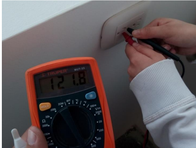
Figura 88. Tomacorrientes del Laboratorio India 3
