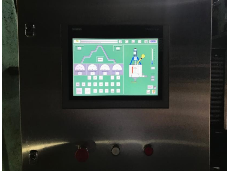
Figura 33. Pantalla PT-1200 utilizado en el control Scada para el monitoreo y control de señales
