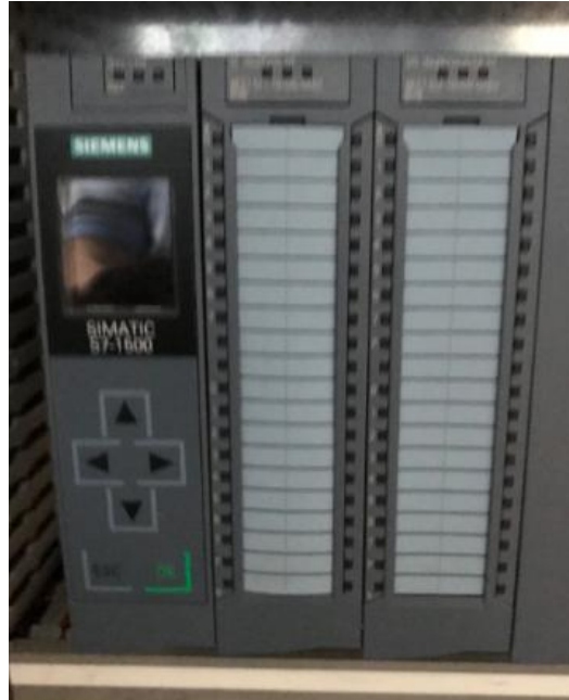
Figura 32. PLC S7-1500 utilizado en la automatización nueva de la centrífuga Wester State
