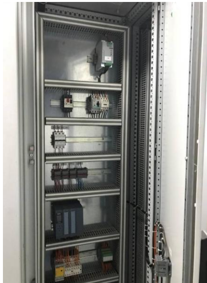
Figura 51. Ubicación del nuevo PLC en su gabinete
