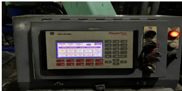
Figura 50. Control obsoleto de centrifugadora del Ingenio Magdalena, S. A.
