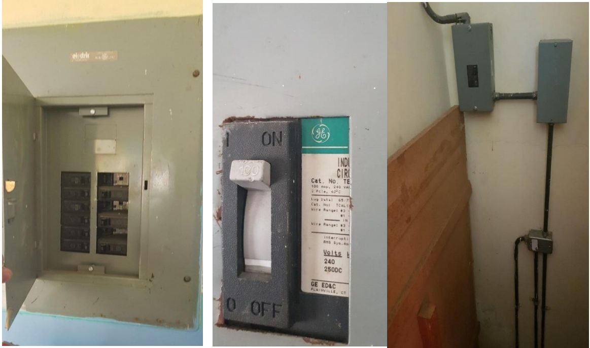
Figura 11. Situación actual de los tableros de distribución
