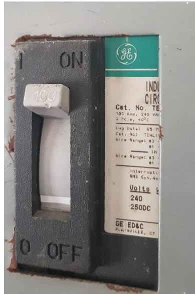
Figura 12. Tablero de distribución principal
