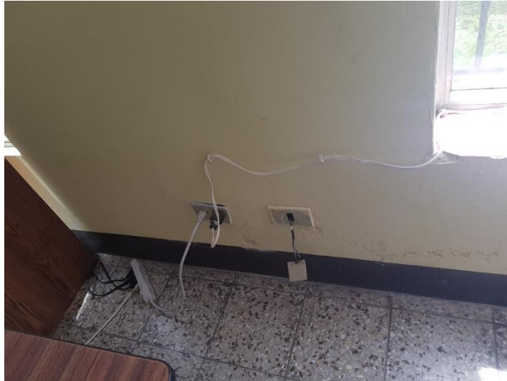
Figura 10. Situación actual de los conductores
