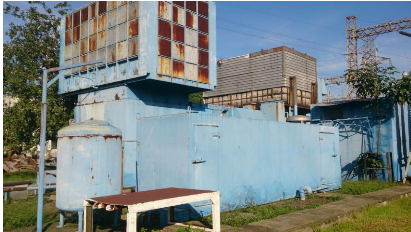
Figura 25. Unidad generadora gas núm. 4
