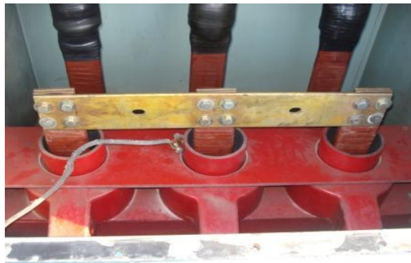
Figura 23. Conexión punto estrella de la unidad generadora gas núm. 3
