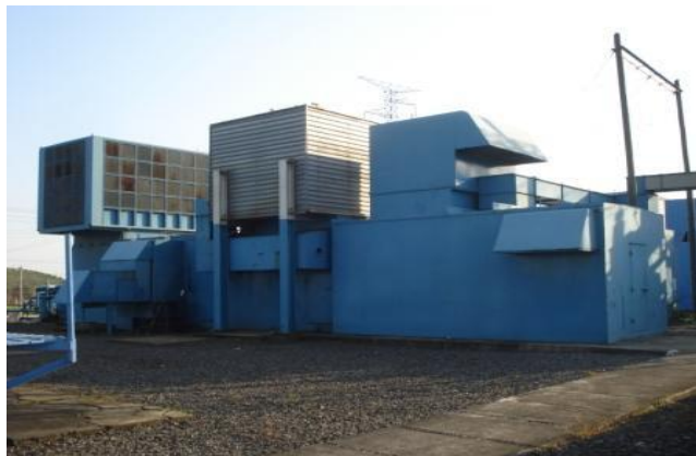
Figura 21. Unidad generadora gas núm. 3
