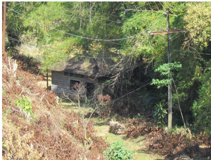
Figura 25. Casa de máquinas de la microcentral de la hidroeléctrica de la finca San Carlos
