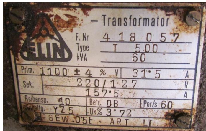
Figura 50. Placa de datos transformador dañado de 60 KVA
