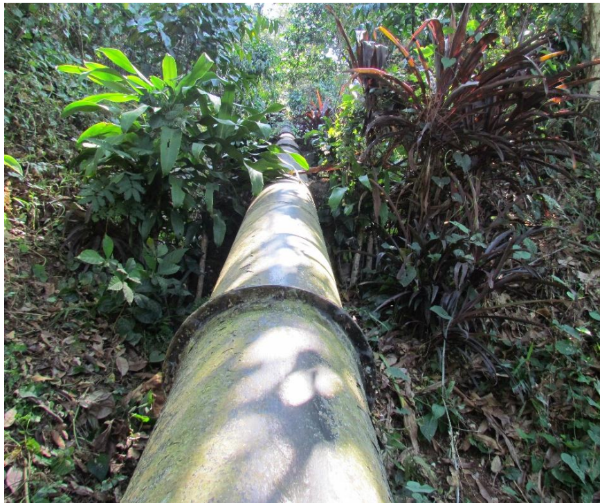
Figura 41. Parte superior de la tubería de presión
