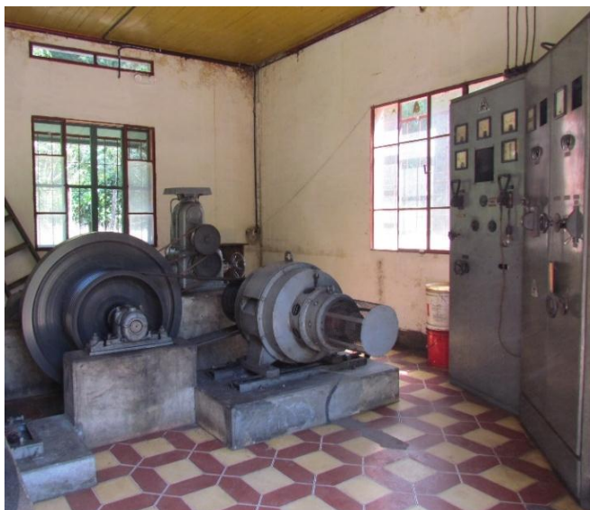
Figura 45. Interior de la casa de máquinas
