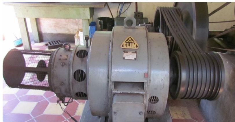
Figura 49. Generador síncrono de 60 KVA y su acople a la turbina
