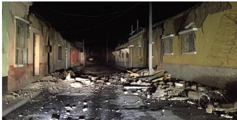
Figura 52. Vivienda de adobe con daños en Quetzaltenango
