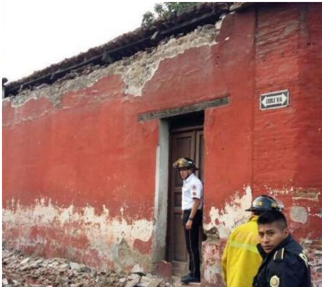
Figura 67. Vivienda con daños en Antigua Guatemala
