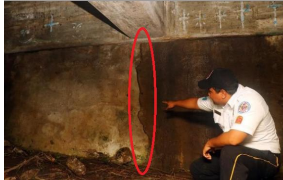
Figura 66. Grieta en puente Carmen de Mirón, Retalhuleu
