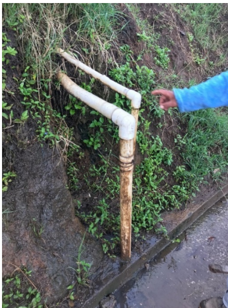
Figura 26. Tubería expuesta en colonia Monja Blanca
