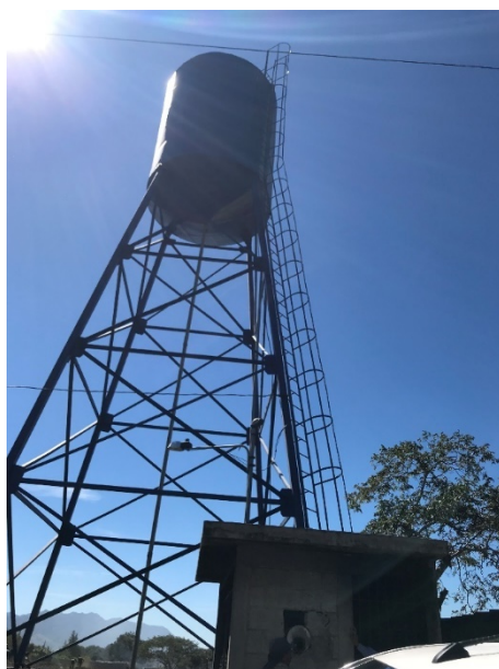
Figura 23. Tanque del almacenamiento El Jocotillo II
