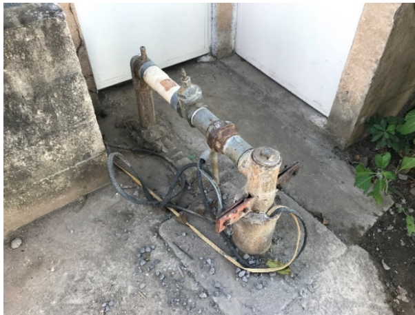
Figura 20. Pozo de agua potable Zapote
