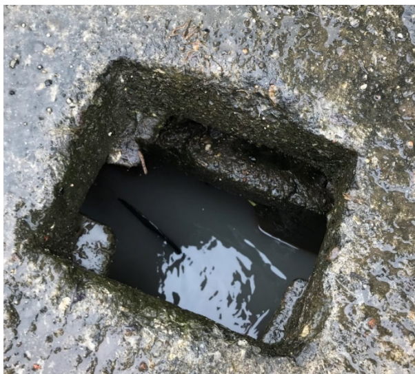
Figura 31. Agua residual desechada en cuneta
