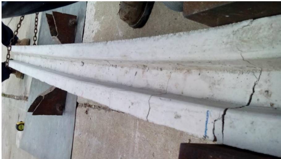
Figura 147. Vista desde el empotramiento de fisuras, grietas y deriva del elemento
