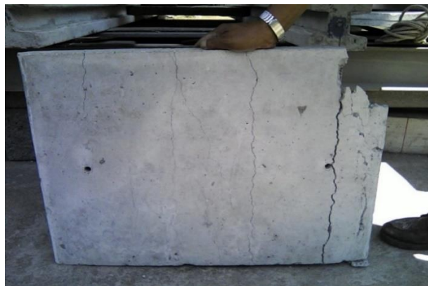
Figura 130. Fisuras y grietas producidas por esfuerzos de flexión, paralelas al armado de acero
