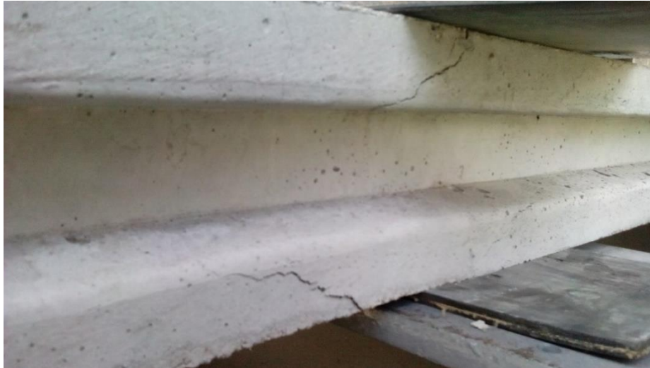
Figura 123. Fisuras producidas en las pestañas del poste debido a la flexión
