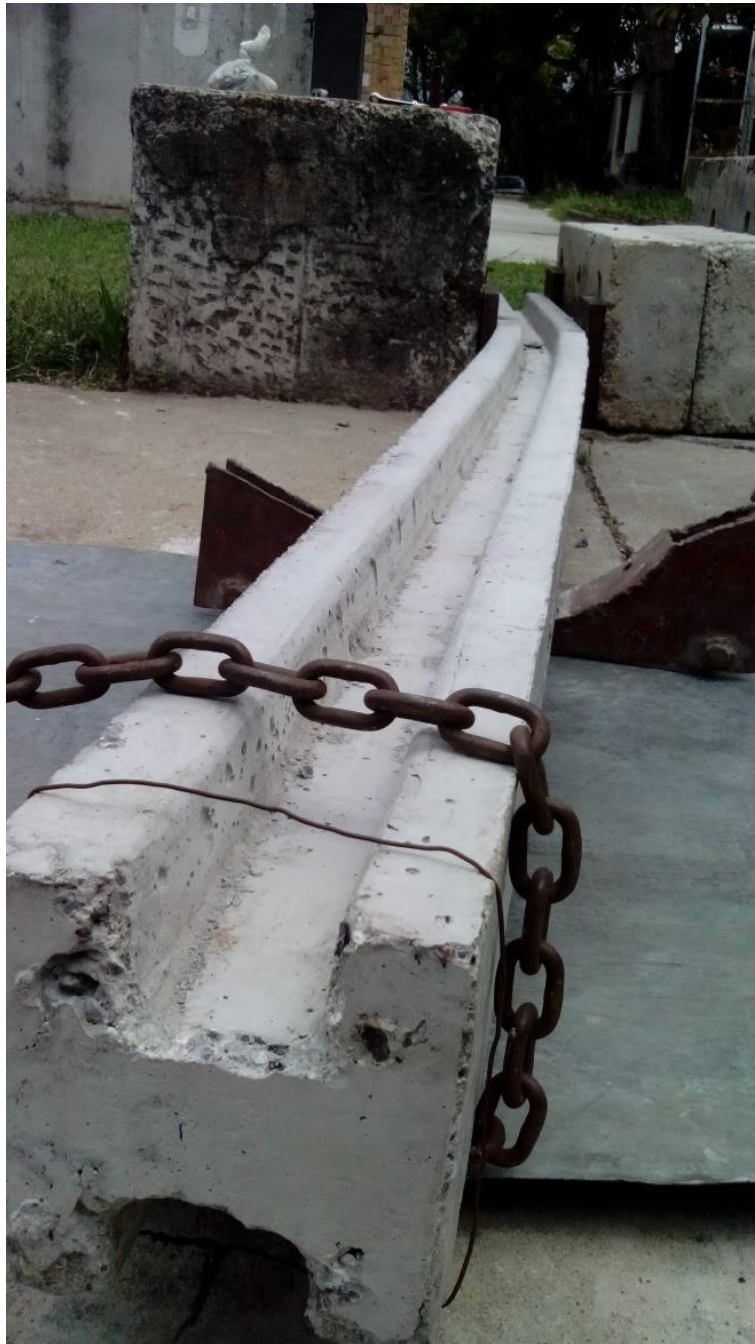
Figura 148. Apreciación de desplazamiento de la parte superior del poste por flexión
