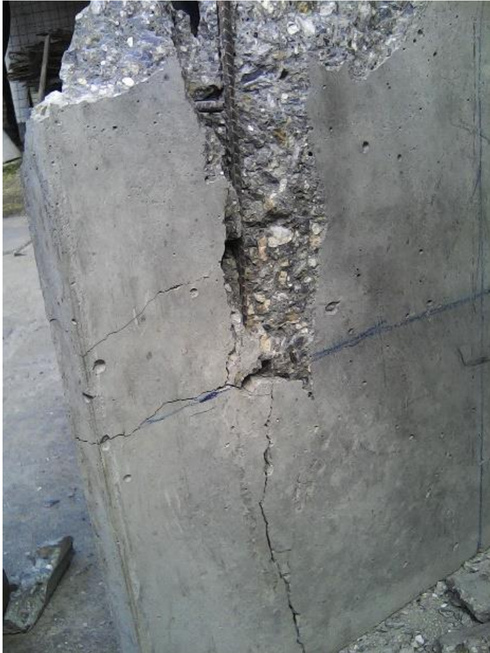
Figura 133. Dirección de grietas, paralelas al lado corto sobre el refuerzo
