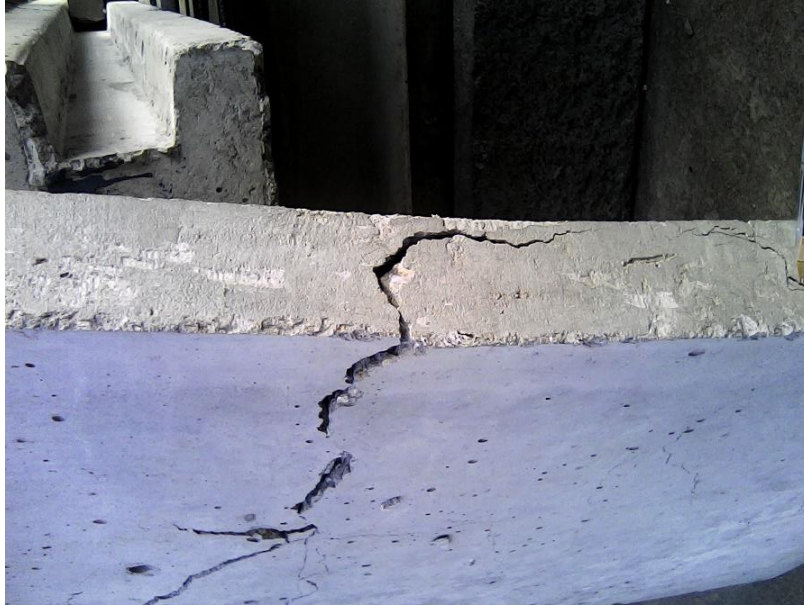
Figura 131. Vista de grietas en el concreto producidas por la flexión en las placas
