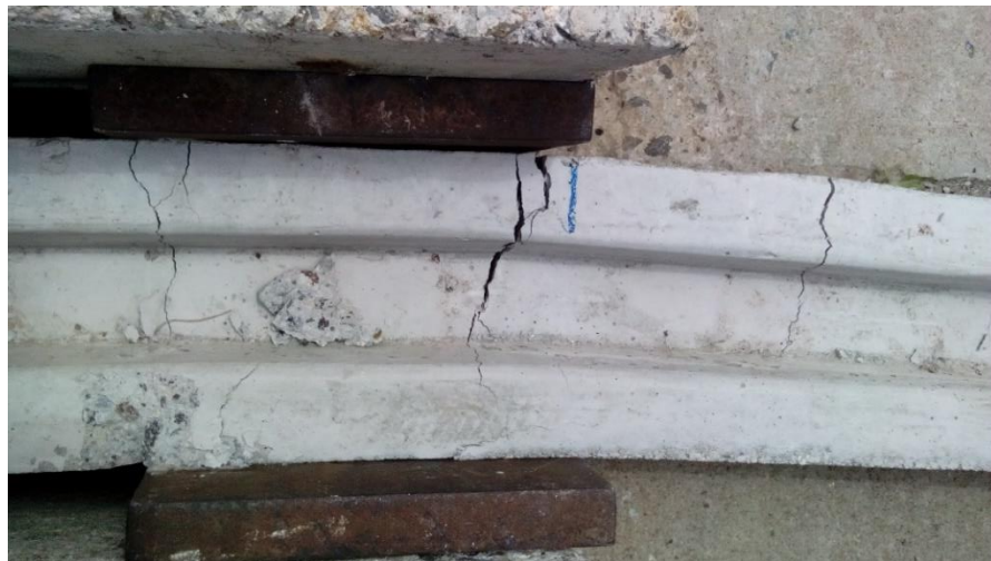
Figura 145. Agrietamiento entre el límite del empotramiento y la luz libre
