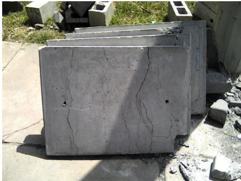
Figura 132. Todas las placas presentaron el mismo patrón de agrietamiento
