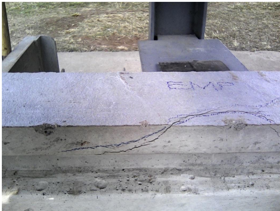
Figura 124. Fisuración causada por compresión en la base del empotramiento del poste
