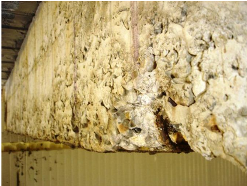
Figura 41. Efecto de la carbonatación en el concreto
