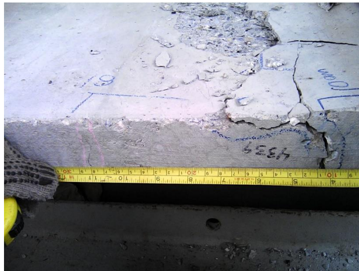
Figura 135. Agrietamiento en las placas, aproximadamente a L/3 de la luz libre
