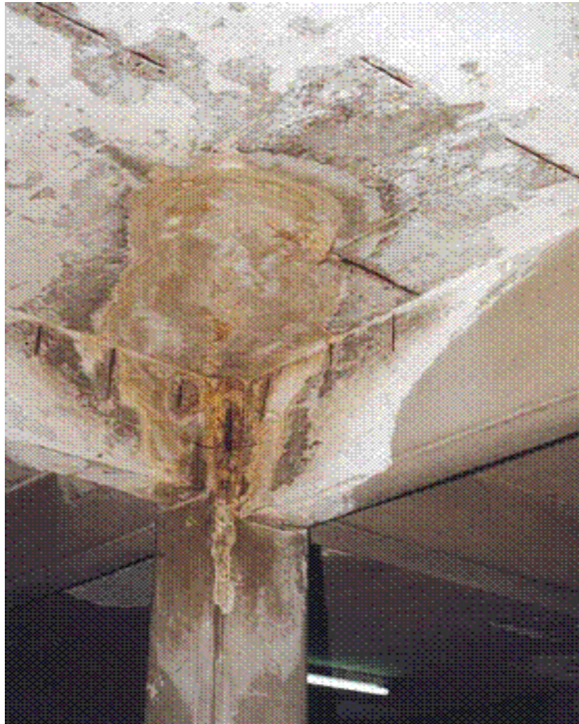
Figura 42. Lixiviación en el concreto
