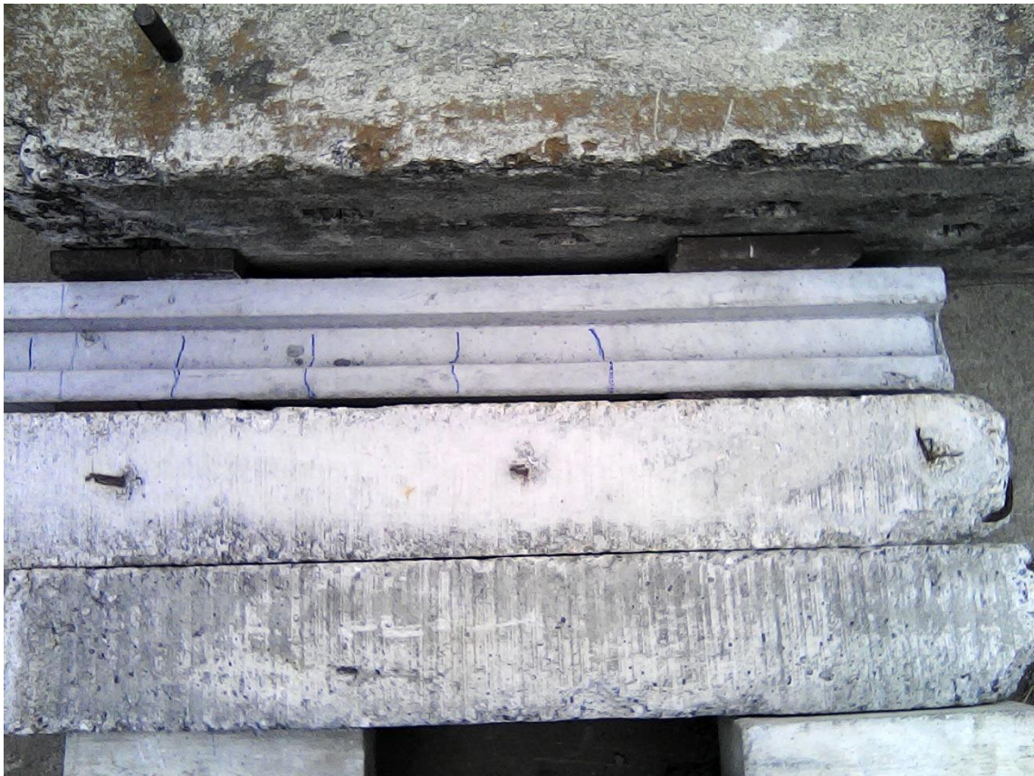
Figura 143. Fisuras en el empotramiento, posterior a la flexión del elemento
