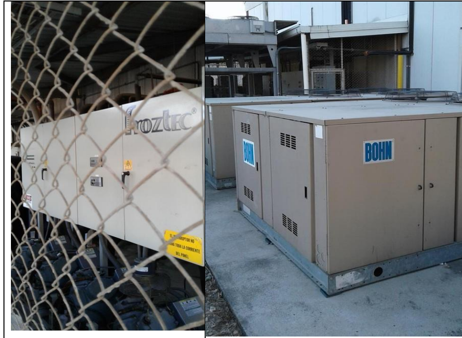
Figura 4. Equipo de refrigeración
