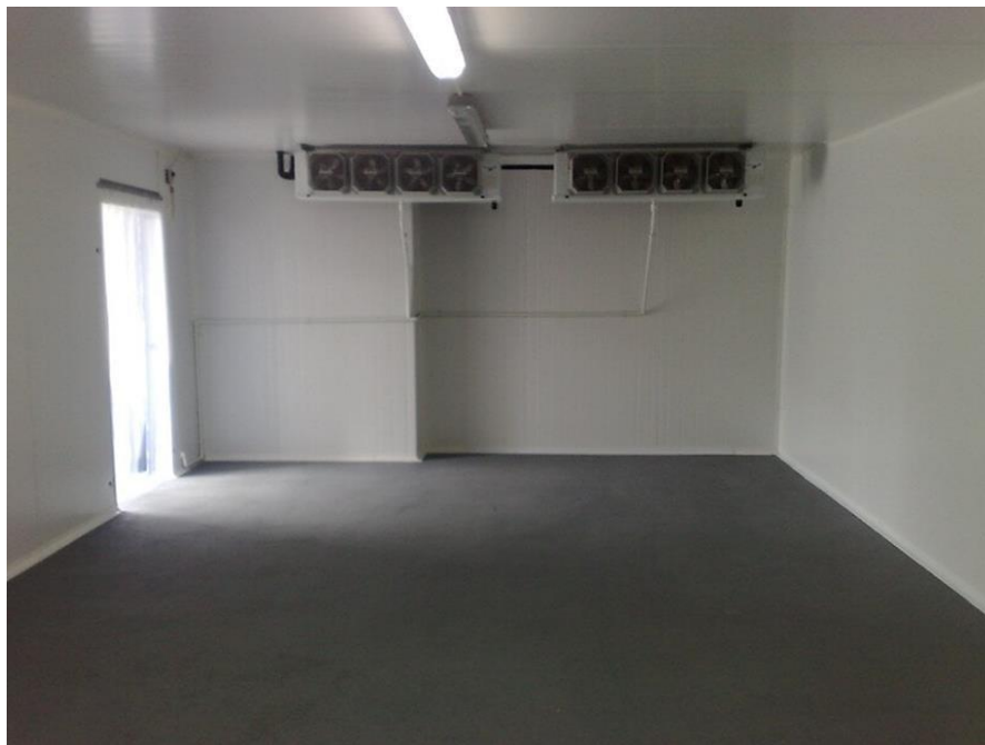
Figura 1. Vista interior de cuarto frío
