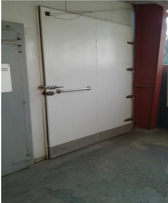
Figura 5. Puerta de cuarto frío
