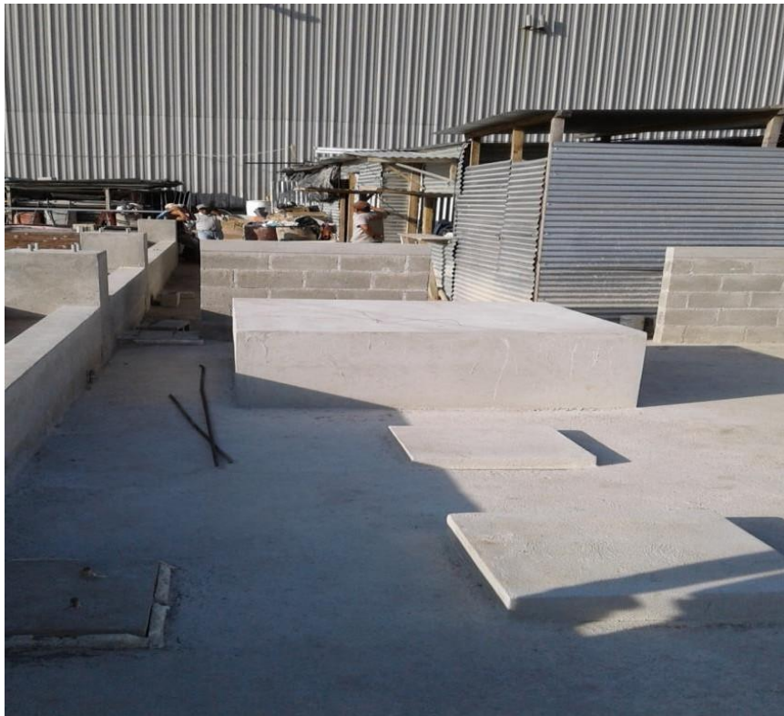
Figura 33. Detalle de bases de concreto para equipos de cuarto frío
