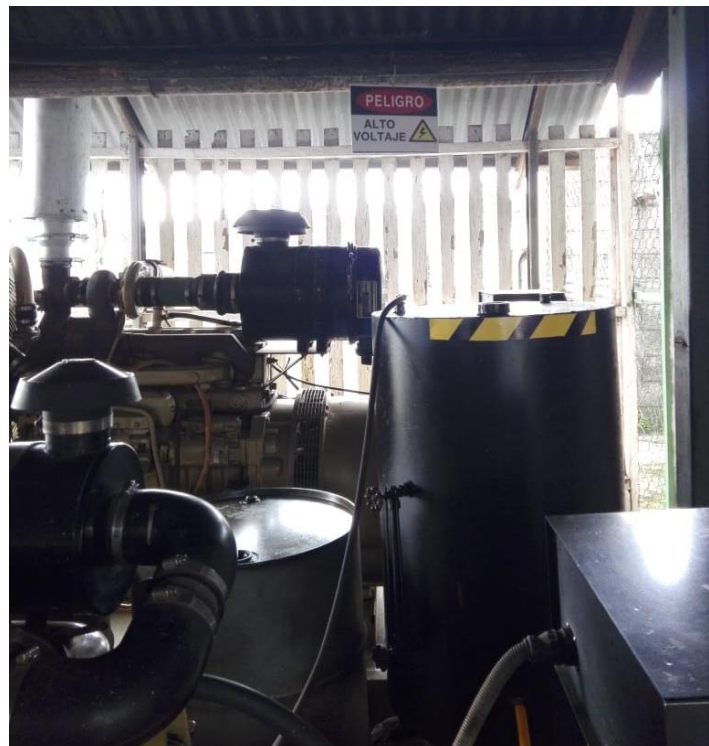
Figura 13. Identificador de alto voltaje en la planta de la finca Agrícola San Jaime S.A. y cinta de precaución.
