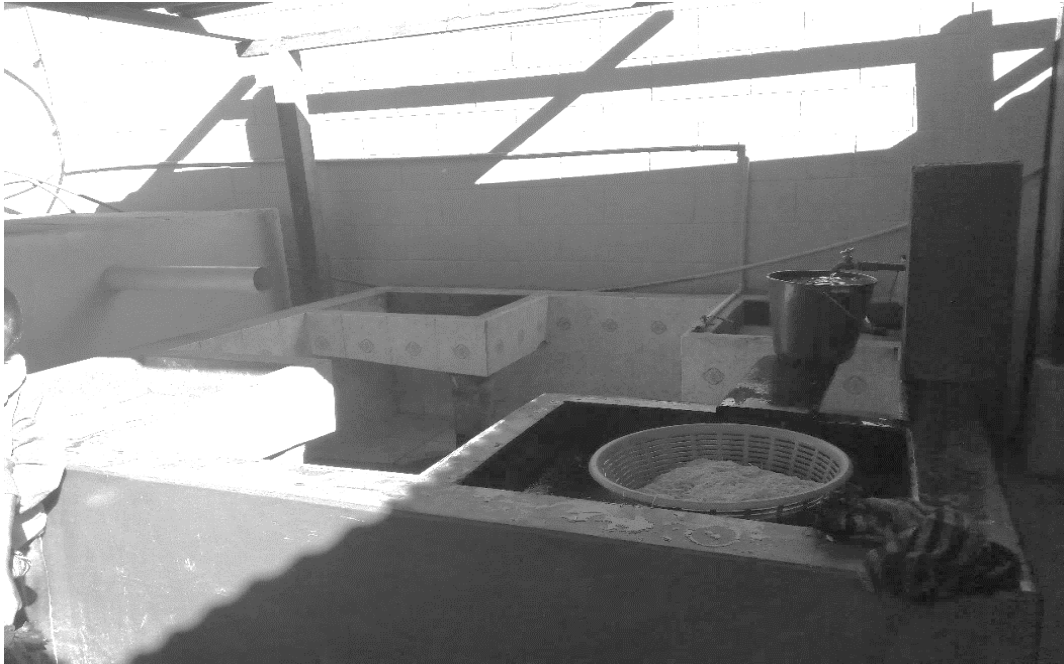
Pila sin remodelar
