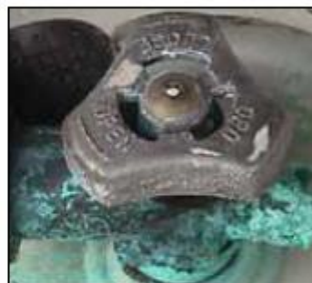
Mancha de amoníaco anhidro
