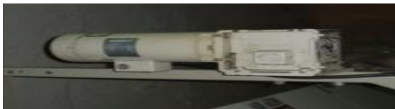
Figura 7. Motoreductor carro de perímetro de colchón
