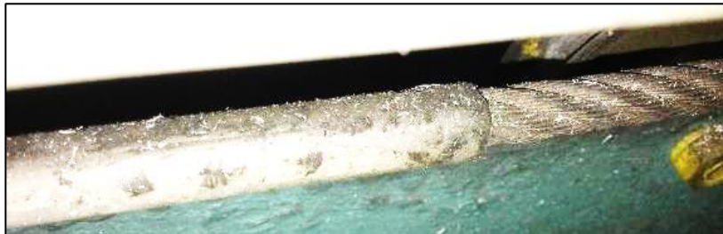
Figura 10. Cable sin revestimiento de caucho
