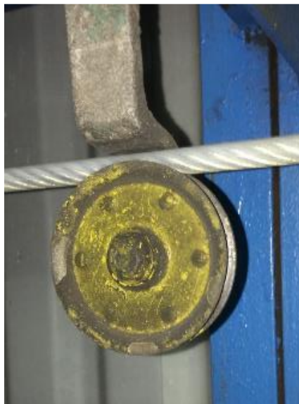
Figura 12. Polea con desgaste en rodamiento
