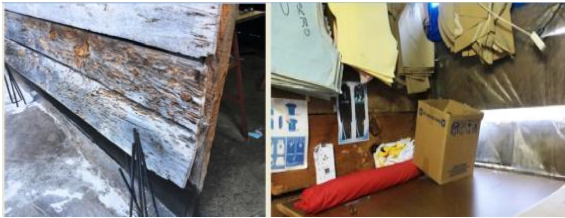
Figura 16. Estado de paredes
