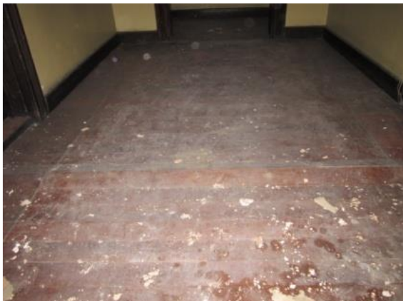
Estado actual del piso de madera en el 2do. nivel
