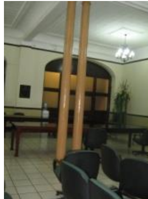
Vista de muros que rodean el salón Larrazábal, y columnas de metal
