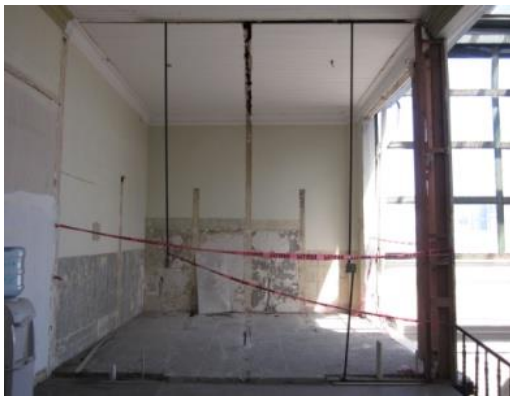
Servicio sanitario en 2do. nivel
