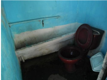
Fotografía No. 4 Baño inhabilitado por mal funcionamiento y falta de agua.
