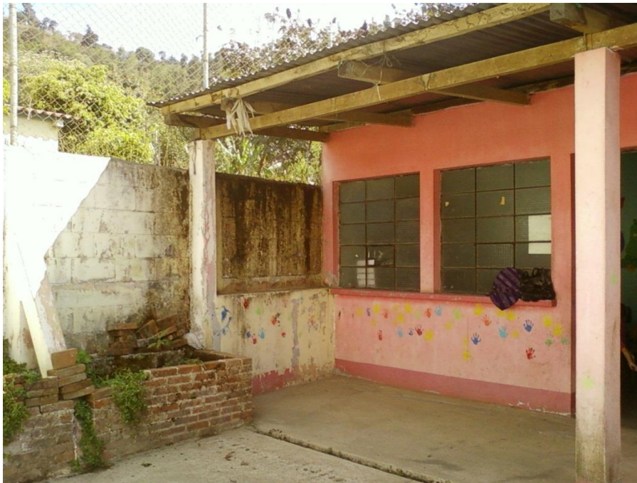
Las ventanas no tienen balcones, esto ha permitido que entren personas a robar dentro de las aulas.
