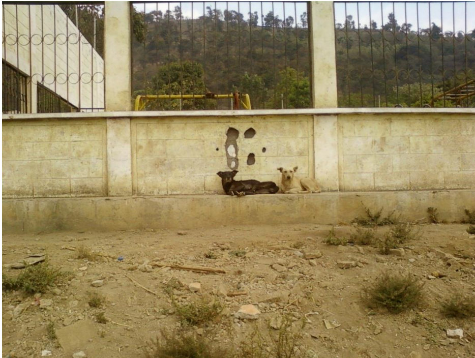
Daño a la infraestructura de la escuela haciéndola insegura.
