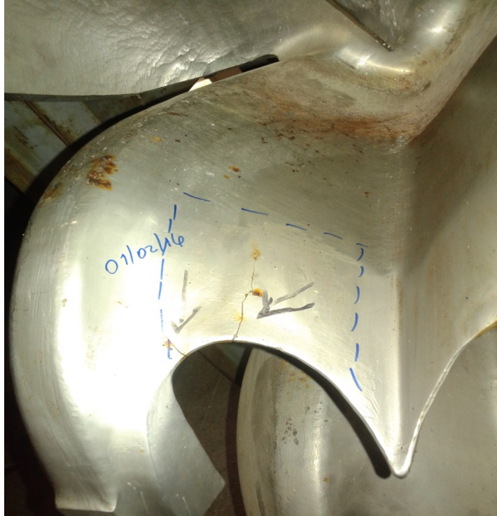
Figura 8. Fisuras- fatiga corrosión
