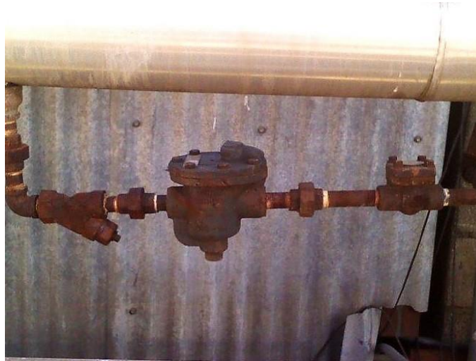
Figura 11. Imagen de una trampa de vapor en buen estado
