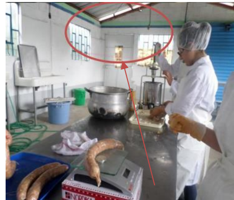
Fotografía No.25 Techo Es de lámina y se encuentra con boquetes que permiten con más facilidad que ingrese la contaminación o bacterias del exterior Fuente: Centro de Estudio del Mar y acuicultura
