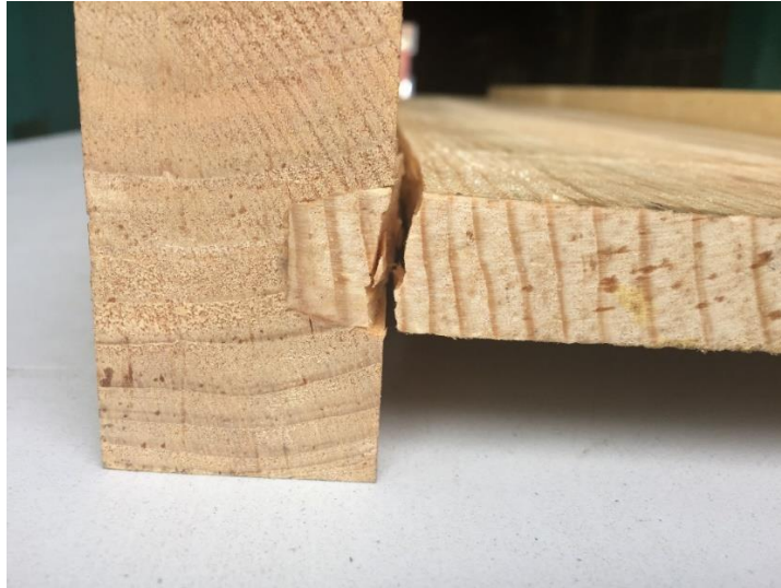
Figura 56. Falla paralela a la unión alma patín de viga B 1
