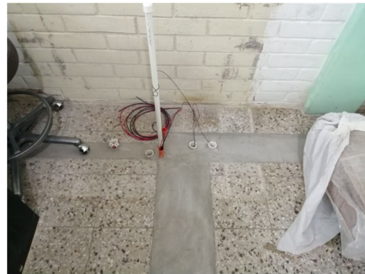
Instalaciones para equipo nuevo
