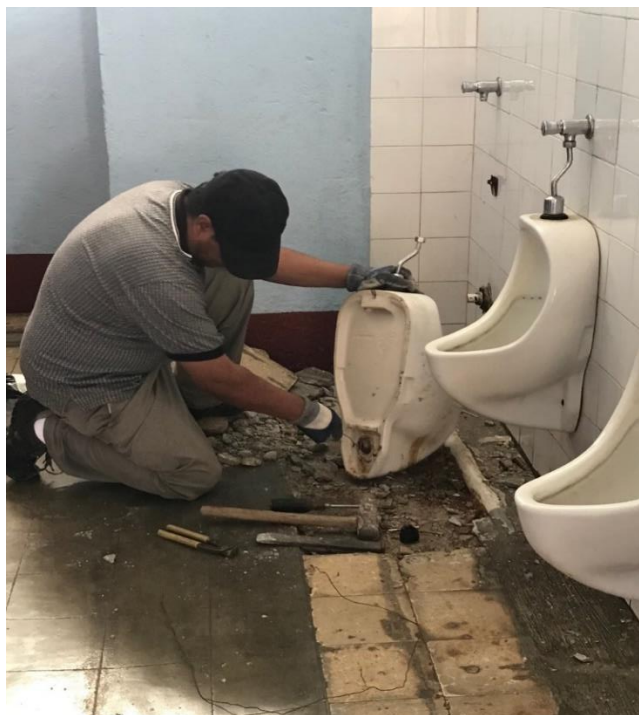
Fotografía 2. Fotografía durante el programa del proyecto comunitario. Mantenimiento de los mingitorios y levantamiento del piso debajo de éstos.
