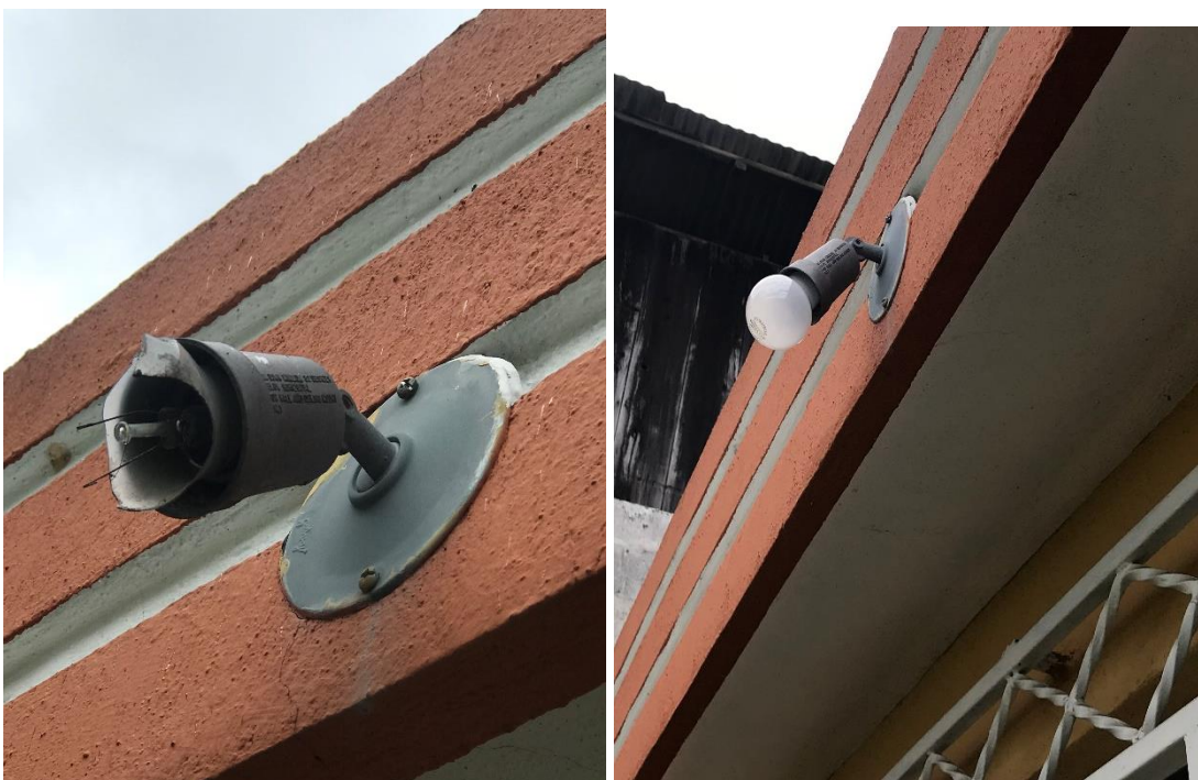
Fotografía 6. Cambio de Foco frente a la sala de espera.
