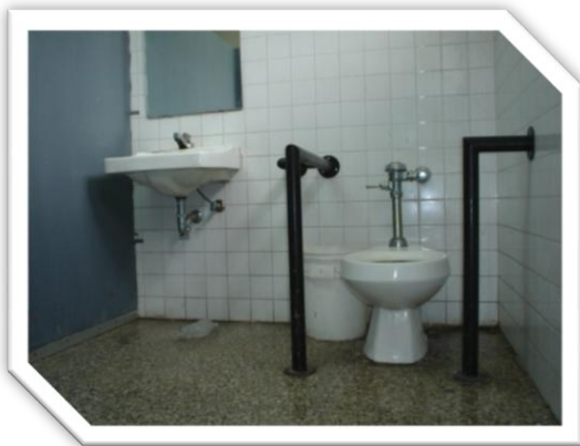
Se ubican dispositivos para personas con discapacidad en los servicios sanitarios.
