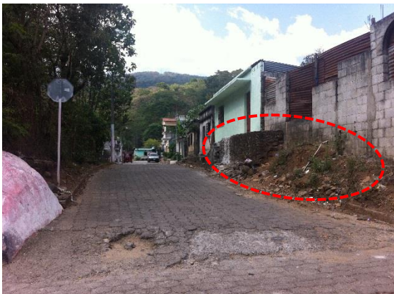
Foto No.58, Interrupción y falta de banqueta, Fuente: Propia
