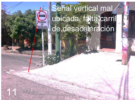
Foto No.33, Mala ubicación de parada de bus carretera principal CA-8, Fuente: Propia
