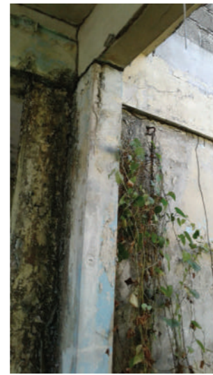
DAÑOS EN EXTERIORES DE MUROS Y COLUMNAS DEBIDO AL CRECIMIENTO DE LA VEGETACIÓN Y A LA HUMEDAD QUE SE ACUMULA EN ELLOS.
