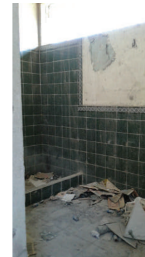
SERVICIOS SANITARIOS CON DAÑOS EN REVESTIMIENTOS DE MUROS, ARTEFACTOS SANITARIOS Y ACCESORIOS FUERON QUITADOS O SE ENCUENTRAN DAÑADOS
