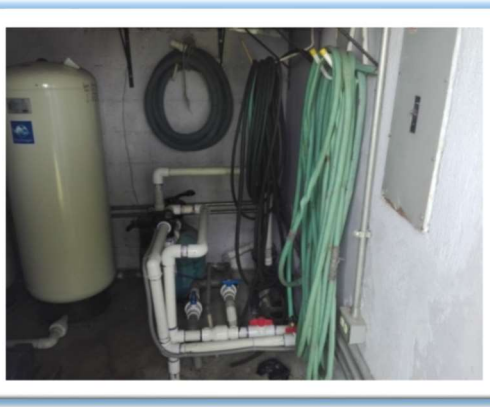
Fotografía 10, Equipo de Bombeo Hidroneumático
