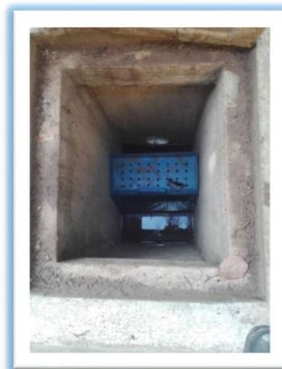
Fotografía 54, Desarenador Planta de Tratamiento
