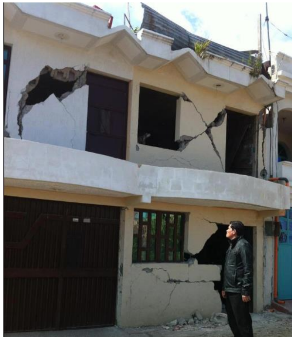
Figura 67. Daño en edificio 5, San Marcos
