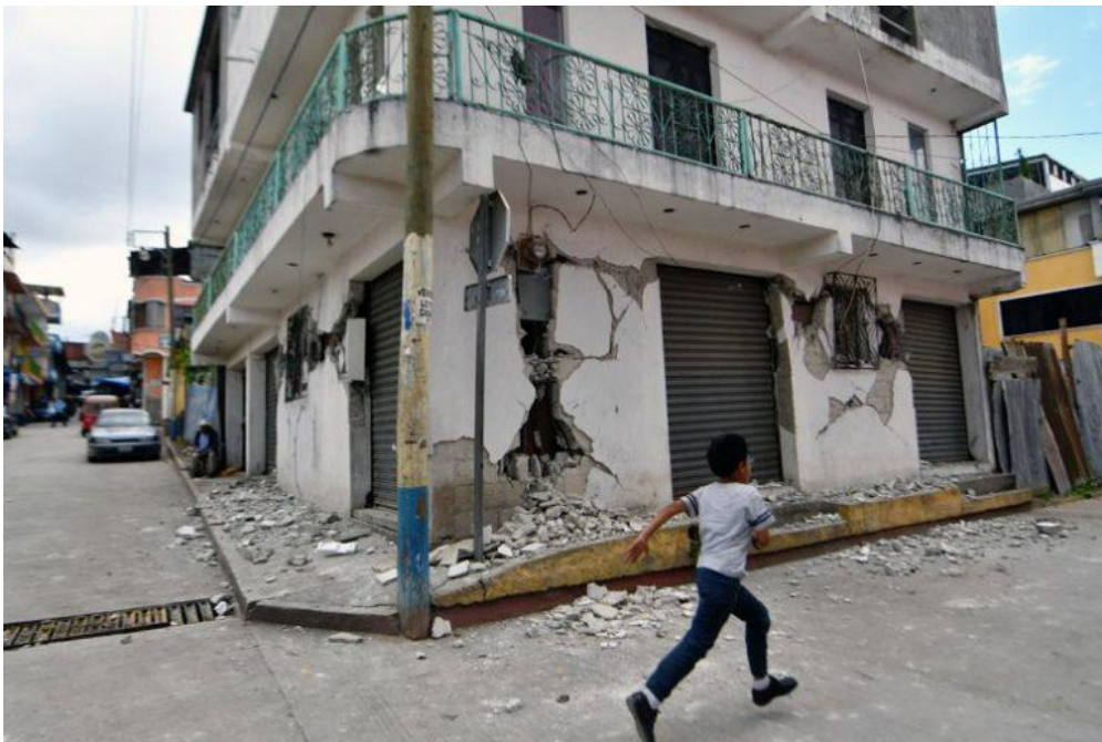
Figura 63. Daño en edificio 1, Tacaná, San Marcos
