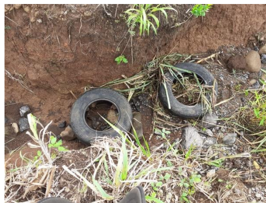
Figura 15: Barrera dañada por las lluvias.
