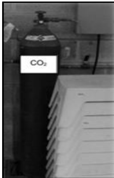
Figura 19. Tanque de dióxido de carbono CO 2
