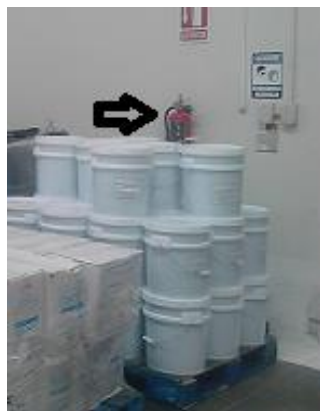
Figura 6. Ejemplo de extintor obstruido
