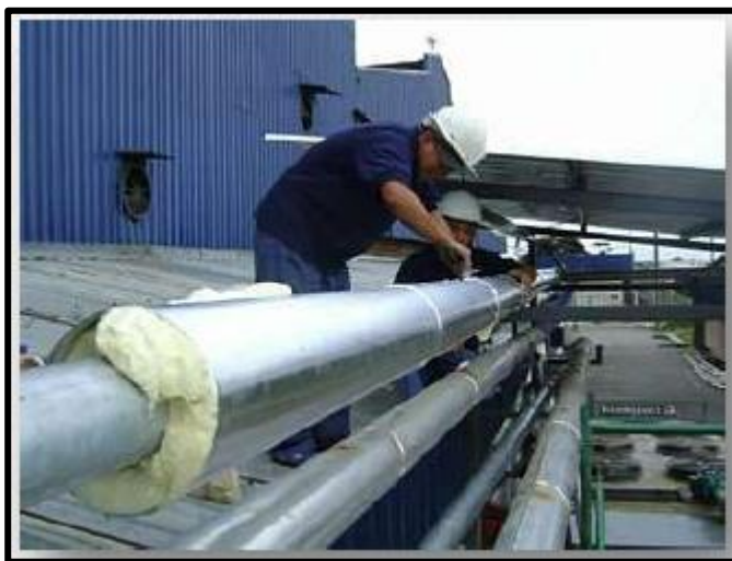
Figura 14. Tubería con aislamiento térmico
