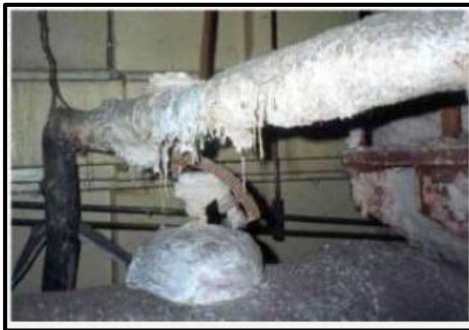
Figura 13. Tubería sin aislamiento térmico
