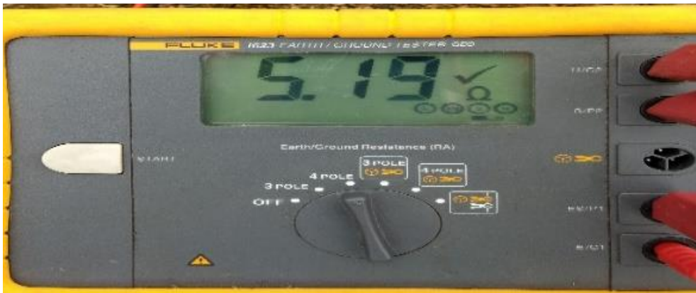
Figura 29. Fotografías tomadas en campo para el cálculo de la resistividad aparente del suelo medición a 4 metros 45 grados
