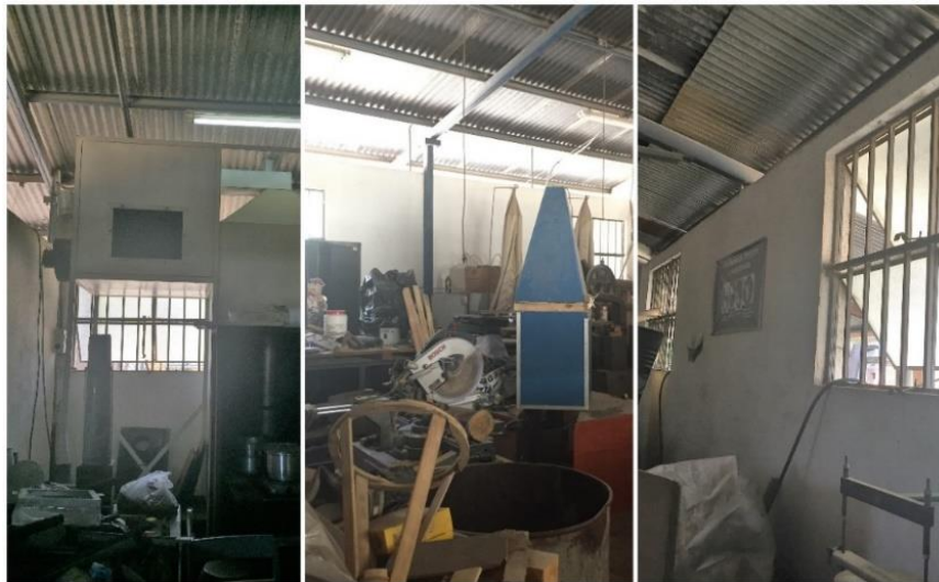
Figura 9. Iluminación actual en Laboratorio Multipropósitos
