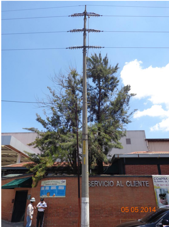
Figura 6. Seccionador en tangente montado en poste
