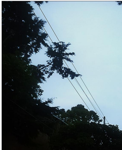
Figura 63. Árbol caído sobre línea de transmisión
