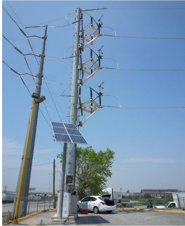
Figura 13. Seccionador trifásico de tres vías alimentado por panel solar
