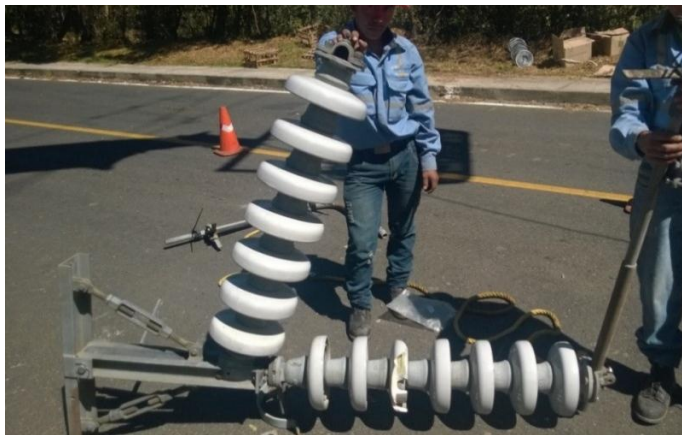
Figura 10. Polo de seccionador convencional retirado de la red
