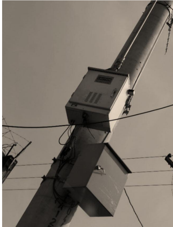
Figura 26. Caja de operación de seccionador
