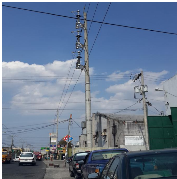
Figura 8. Seccionador de una vía con cámara de extinción de arco instalado en poste
