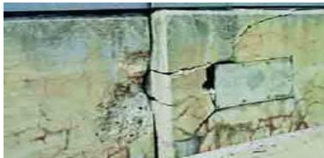
Figura 16. Fisuras por RAS
