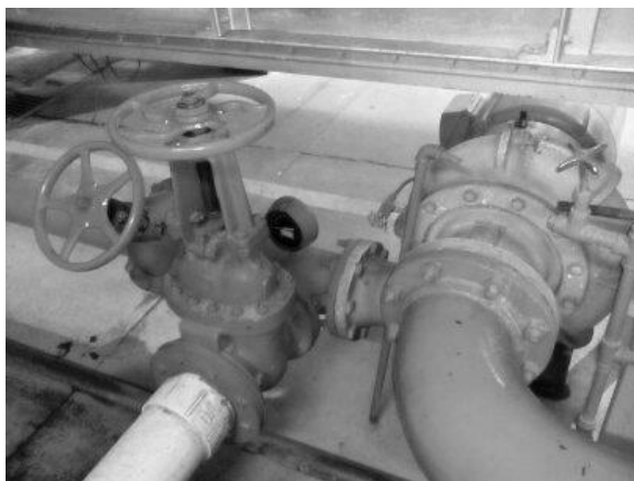
Figura 43. Sistema de bombeo
