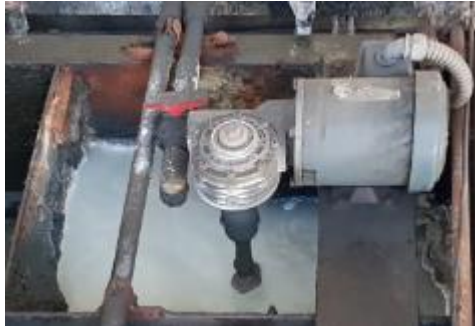
Figura 32. Reactor CSTR de neutralización
