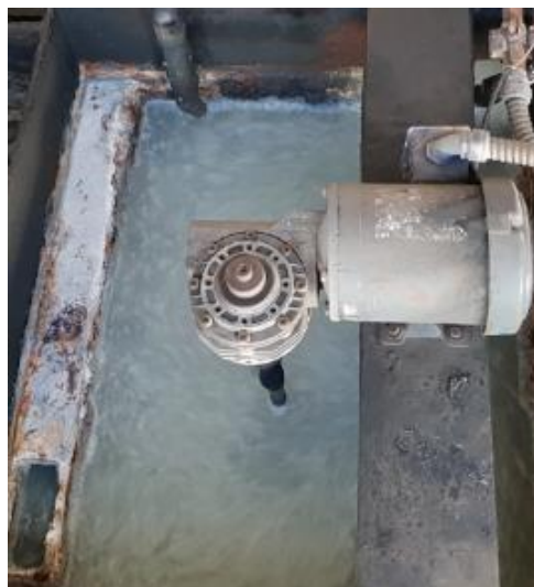
Figura 38. Reactor CSTR de floculación
