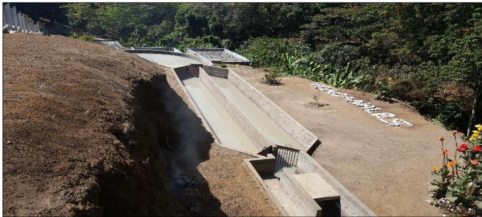
Figura 39. Canal desarenador con rejilla
