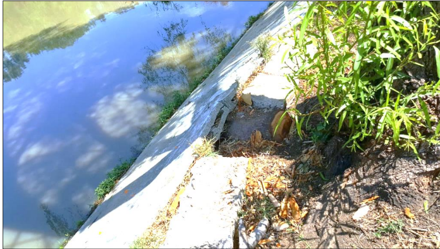
Figura 64. Estructura dañada por la raíz de un árbol
