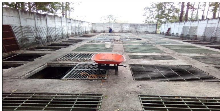
Figura 50. Sedimentadores, tanques tipo Imhoff
