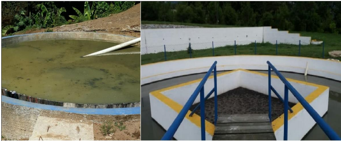
Figura 65. Comparativa de un sedimentador sin trampa de grasas con un sedimentador con trampa de grasas
