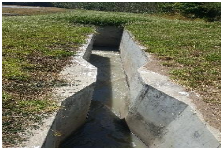
Figura 36. Canal desarenador de PTAR San Agustín las Minas
