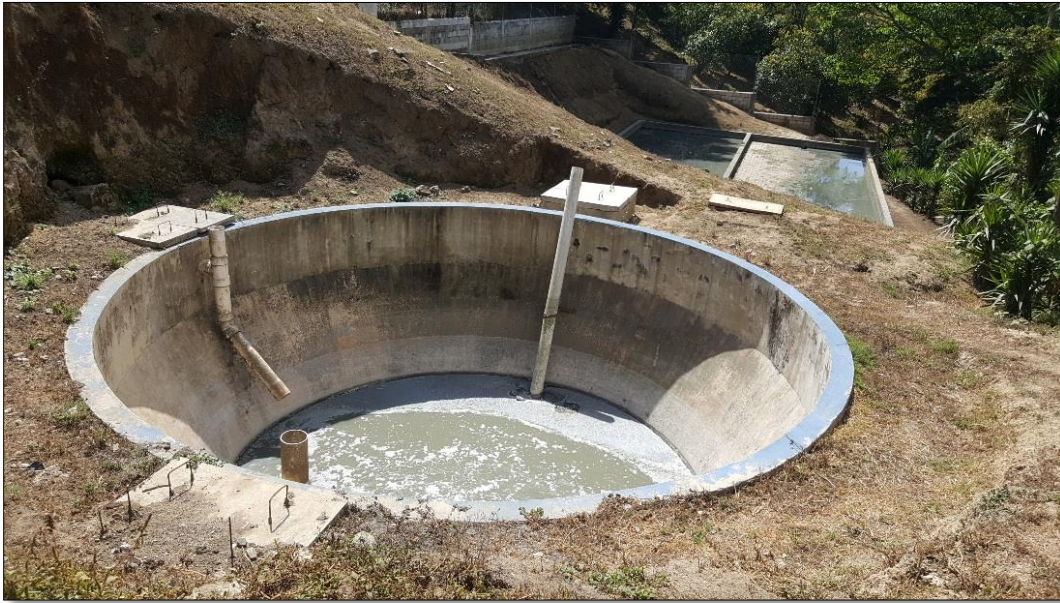
Figura 43. Digestor de lodos
