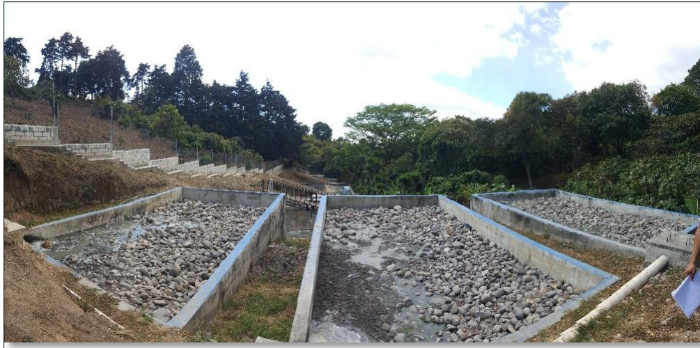
Figura 41. Filtros percoladores de la PTAR Santa Elena Barillas
