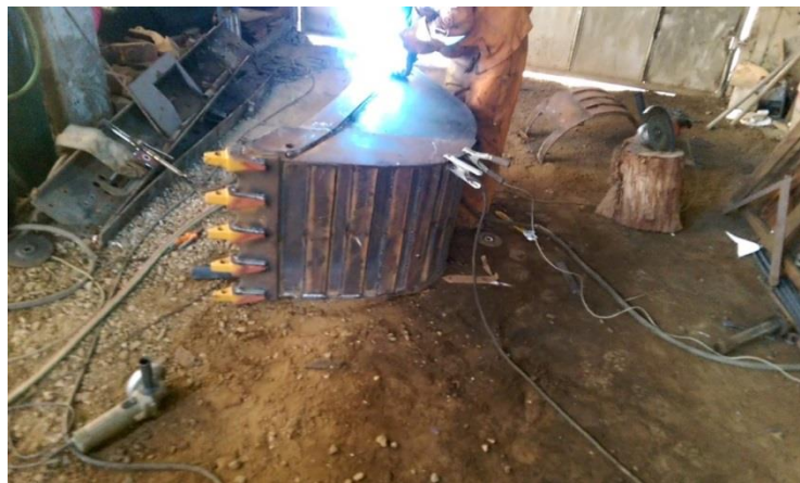
Figura 37. Ruptura por sobrecarga
