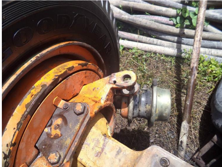
Figura 41. Fractura por sobre esfuerzo
