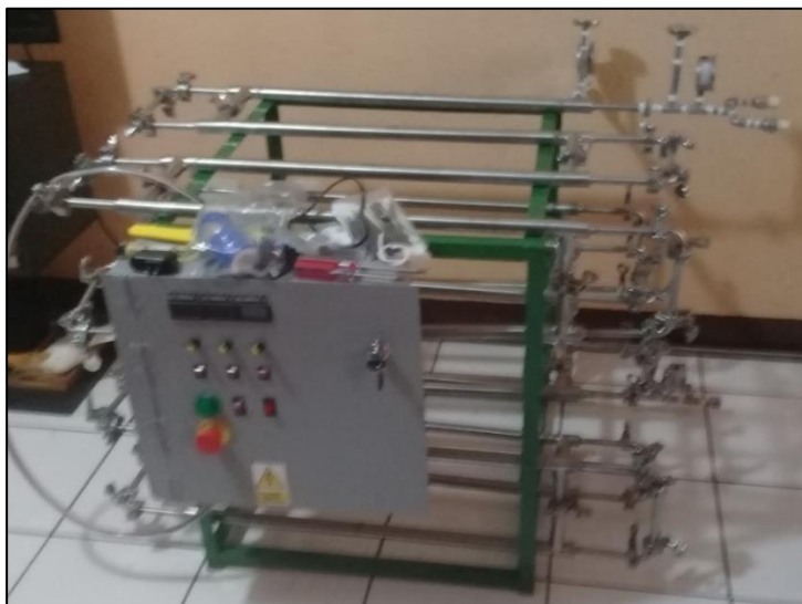
Figura 7. Reactor con tablero eléctrico instalado
