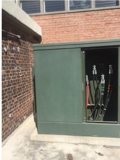
Figura 26. Transformador Pad Mounted 200 KVA
