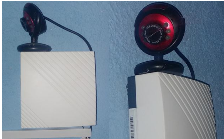
Figura 61. Cámara de seguridad instalada
