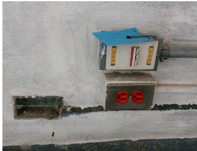
Figura 115. Antigua instalación eléctrica y de red
